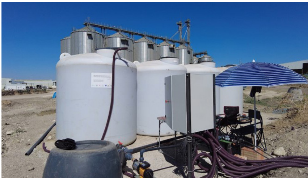
Imagen 7: Colocación del sistema de riego con los efluentes tratados de la entamadora
