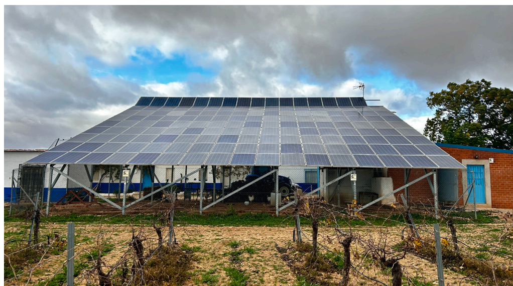
Imagen 10: Paneles solares para alimentar el sistema de riego por bombeo
